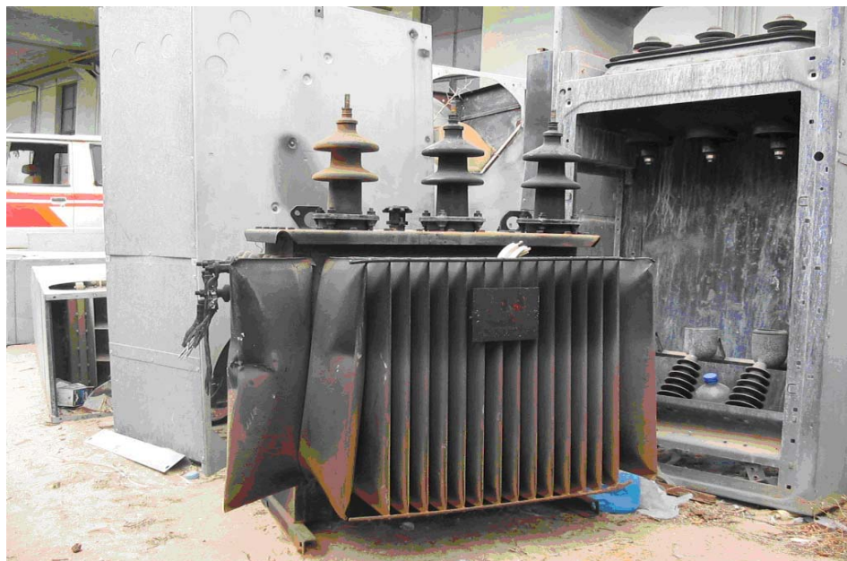
Image 2 : Transformateur ayant brûlé et abandonné sans aucune sécurisation dans la cour de la Direction technique de la SOMELEC (Crédit AGREEM)
