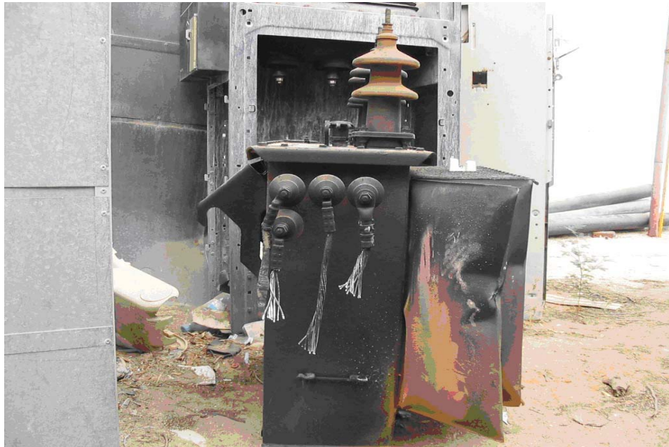
Image 1 : Transformateur ayant brûlé et abandonné sans aucune sécurisation dans la cour de la Direction technique de la SOMELEC (Crédit AGREEM)
