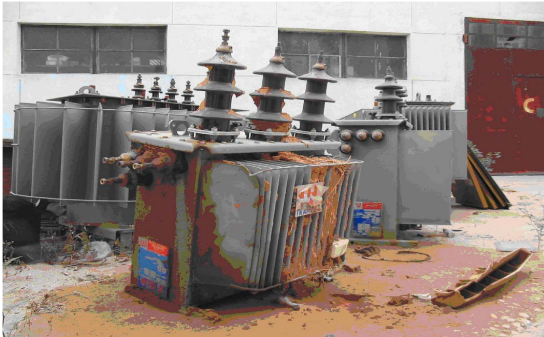
Image 1 : Transformateur ayant brûlé et abandonné sans aucune sécurisation dans la cour de la Direction technique de la SOMELEC (Crédit AGREEM)
